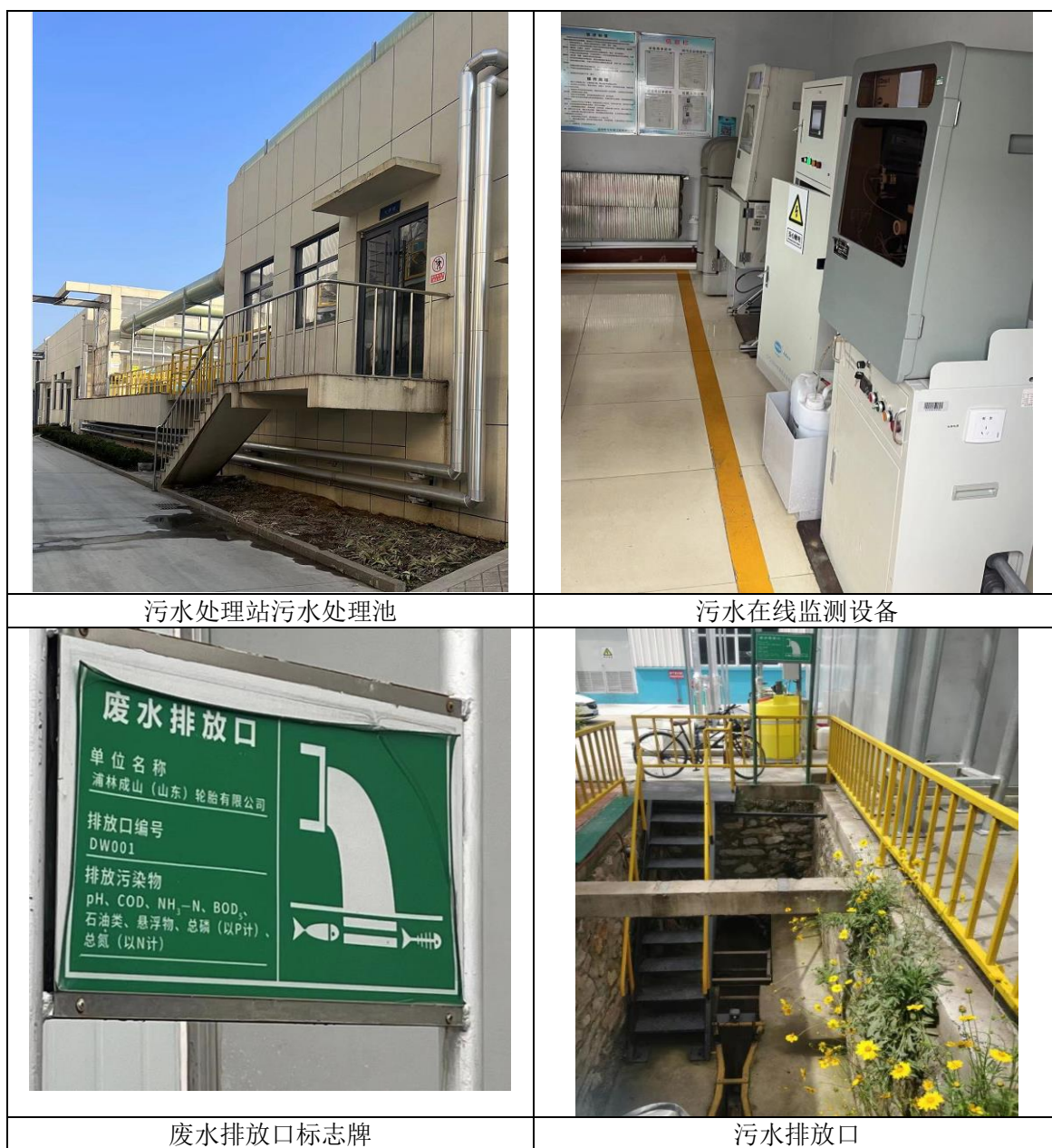
图 4.1-2 现有工程污水处理站现场照片
